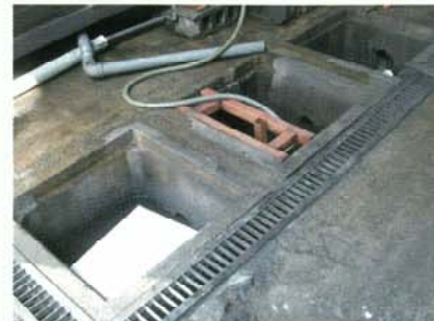
油水分離槽による土壌汚染の防止
