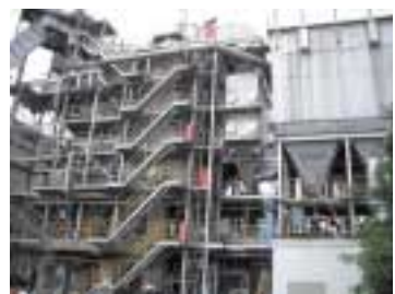
日産自動車追浜工場内に設けられた産業廃棄物処理施設
